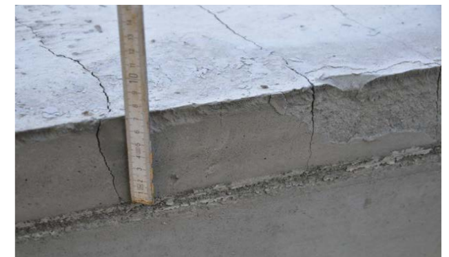
Ρωγμές λόγω πλαστικής συρρίκνωσης σε συγκεκριμένο οδόστρωμα που προκλήθηκε από ανεπαρκή προστασία της επιφάνειας από την πρόωξη ξήρανση.
