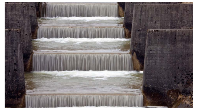
Ιδιαίτερα σε κατασκευές όπου το νερό πέφτει με ορμή, οι επιφάνειες από σκυρόδεμα υπόκεινται σε τεράστιες πρόσθετες καταπονήσεις από ρύπους, σκουπίδια, αιχμηρές ακμές και απότριψη, καθώς και πιθανές θερμικές καταπονήσεις λόγω έκθεσης σε παγετό.
