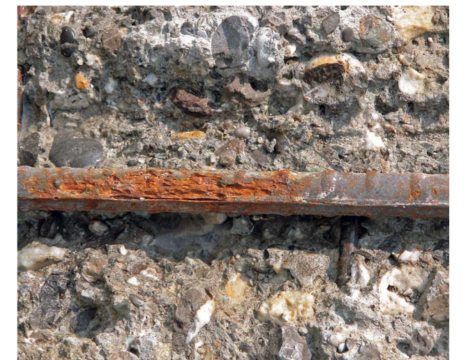
Βλάβη στην κατασκευή σκυροδέματος λόγω ανεπαρκούς κάλυψης του οπλισμού και χαμηλής ποιότητας σκυροδέματος
