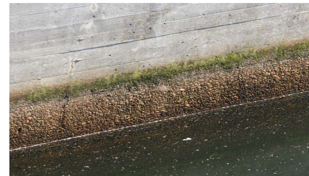
Βαριά έκπλυση και βλάβη του δομικού σκυροδέματος παρατηρείται ιδιαίτερα στις ζώνες ψεκασμού και αυξομείωσης στάθμης των δεξαμενών βιολογικής επεξεργασίας.
