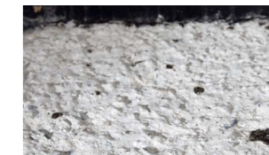
Ιδιαίτερα έντονη επιφανειακή διάβρωση
