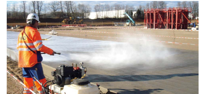
Η άμεση κάλυψη ή η ωρίμανση με άλλα μέσα των εκτεθειμένων επιφανειών από σκυρόδεμα αποτελεί το σημαντικότερο βήμα για την προστασία τους.
