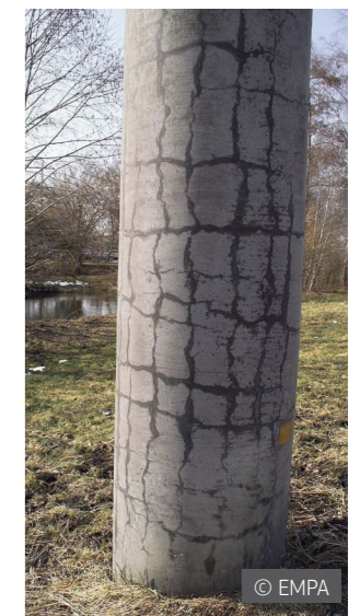
Η εμφάνιση της βλάβης λόγω αλκαλοπυριτικής αντίδρασης μπορεί να αξιολογηθεί πολύ καλά στην επιφάνεια σκυροδέματος του πυλώνα της γέφυρας που στεγνώνει βαθμιαία. Η βλάβη μπορεί να παρουσιαστεί μέσα σε χρόνια ή μόνο μετά από δεκαετίες.
