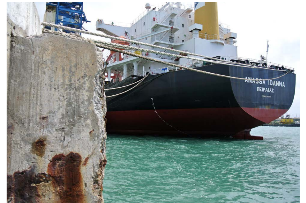
Ανάγκη ενίσχυσης χαλύβδινου οπλισμού σε λιμενοβραχίονα.
