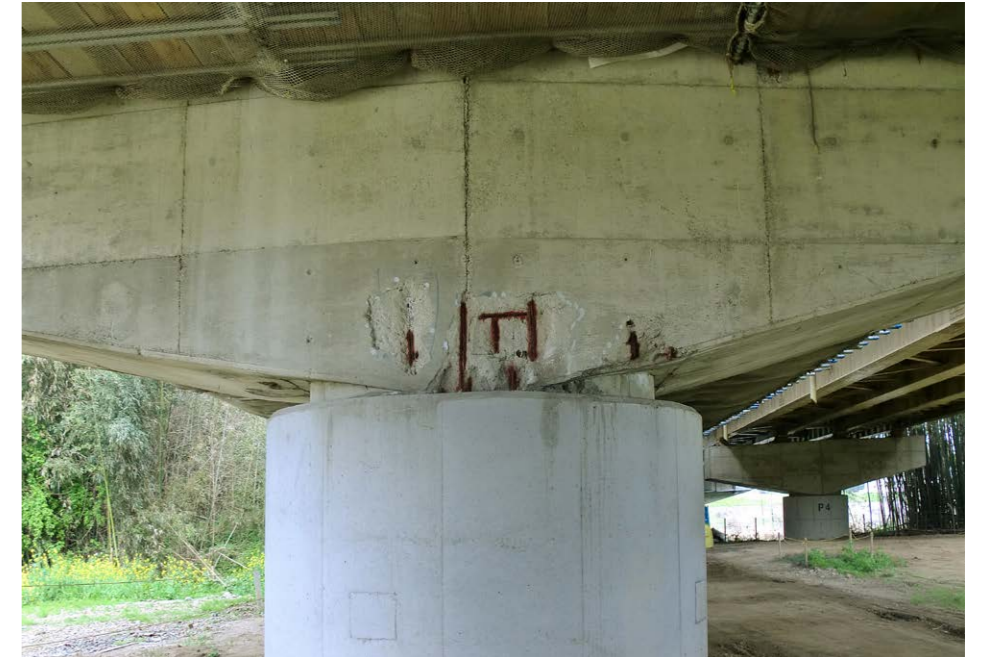
Διάβρωση που προκαλείται από ενανθράκωση, συνδυαστικά με χαμηλή επικάλυψη σκυροδέματος.
