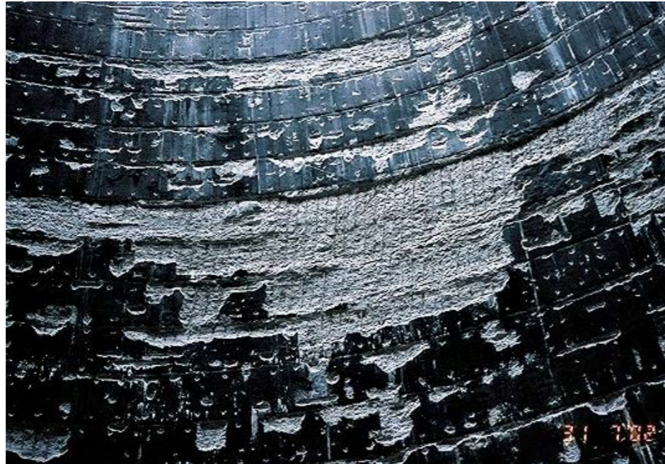
Σοβαρή υποβάθμιση σκυροδέματος και διάβρωση χάλυβα οπλισμού, κατόπιν εφαρμογής ανεπαρκούς/ακατάλληλης επίστρωσης στην εσωτερική επιφάνεια πύργου ψύξης.
