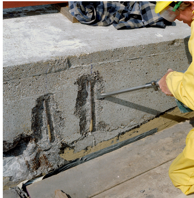
Κατεστραμμένο στοιχείο σκυροδέματος
