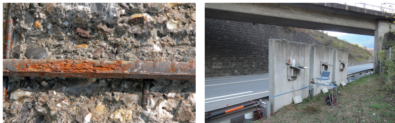
Βλάβη σε κατασκευές σκυροδέματος λόγω ανεπαρκούς κάλυψης και χαμηλής ποιότητας σκυροδέματος.
